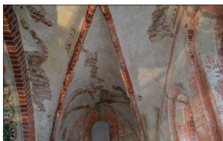
Putzschäden im Gewölbe
