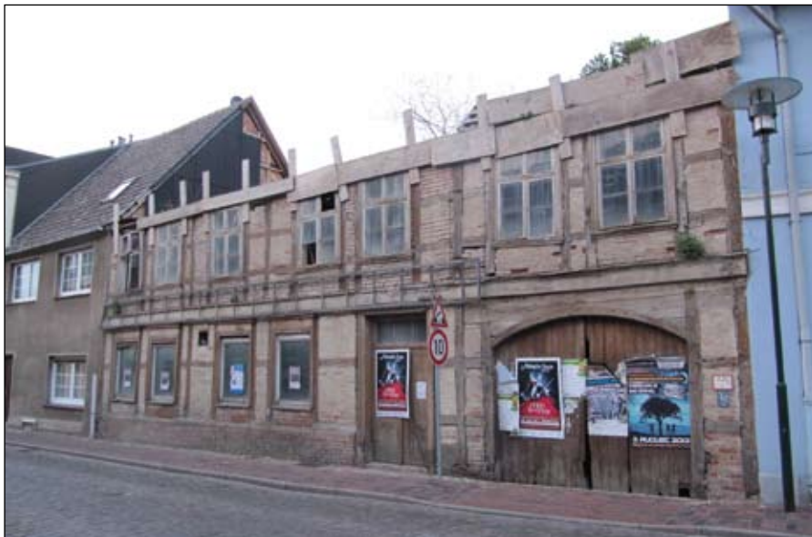
Teile der Fassade des ehemaligen „Ankers“ drohen herabzufallen. Foto: W. H.
