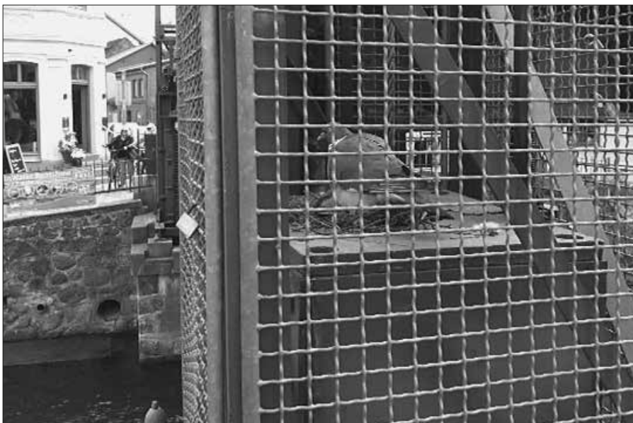
Eine Taube brütet versteckt in der Hubbrücke.
