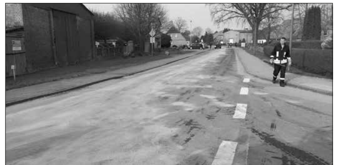
Das ganze Ausmaß der Verunreinigung
