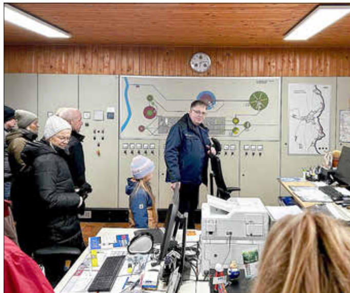
Ein Blick in die Zentrale: Von hier aus wird der gesamte Klärprozess überwacht und gesteuert.
