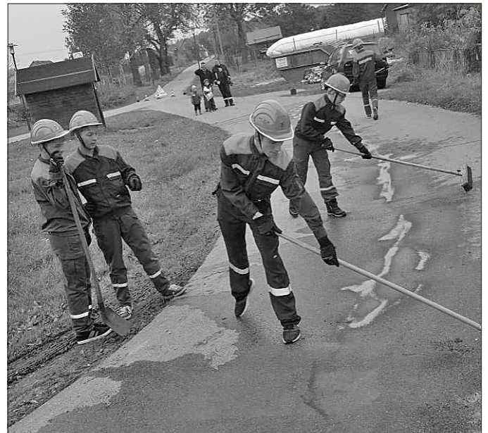
Einsatz zur Beseitigung der Ölspur.
