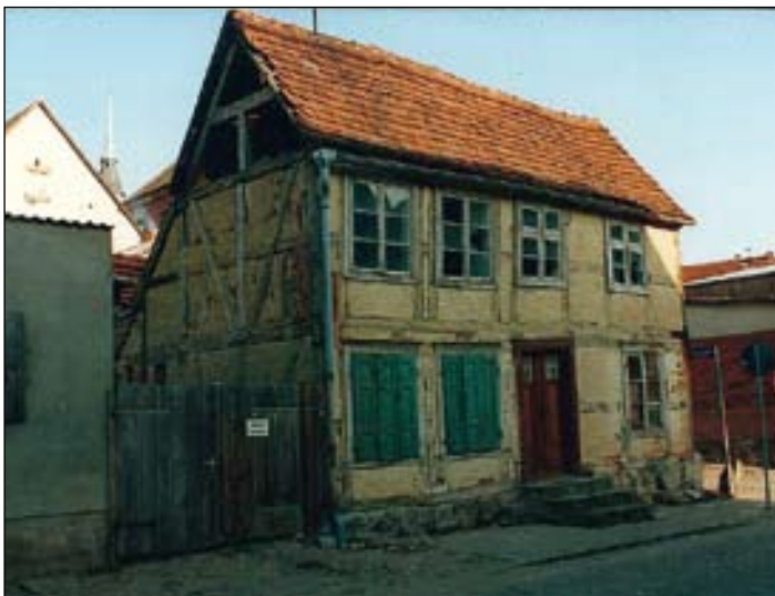
In der Eldenstraße zweimal das gleiche Haus: 1996 unsaniert und 2012 saniert.
