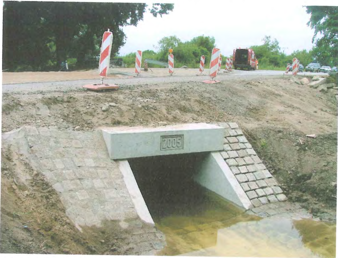
Abb. 8: Neu geschaffener Durchlass zwischen dem Heidensee und dem Plauer See an der B 103
